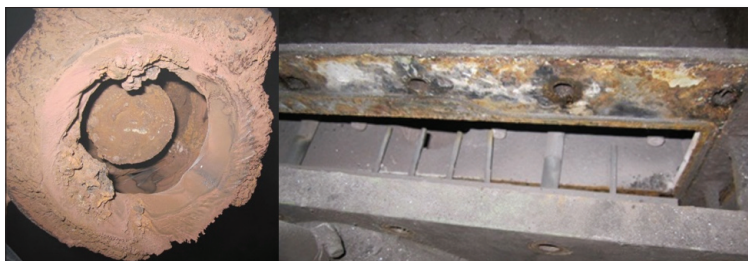
图2 实例(a)喷嘴堵塞、实例(b)瓣式文丘里洗涤塔内损坏的清洁耙
