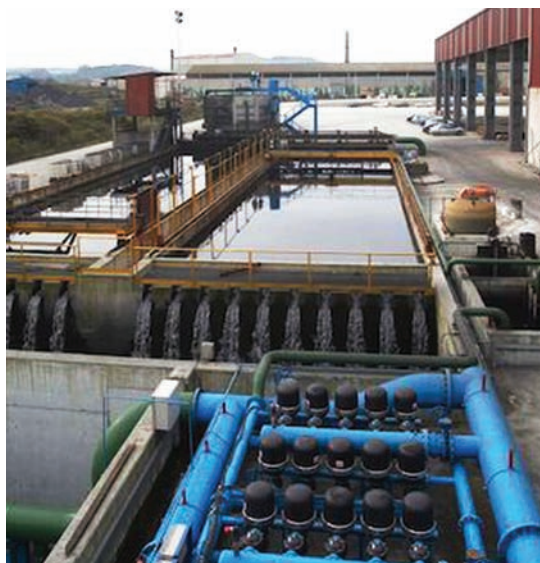
Fig.1 WTP at Siderúrgica Añón
